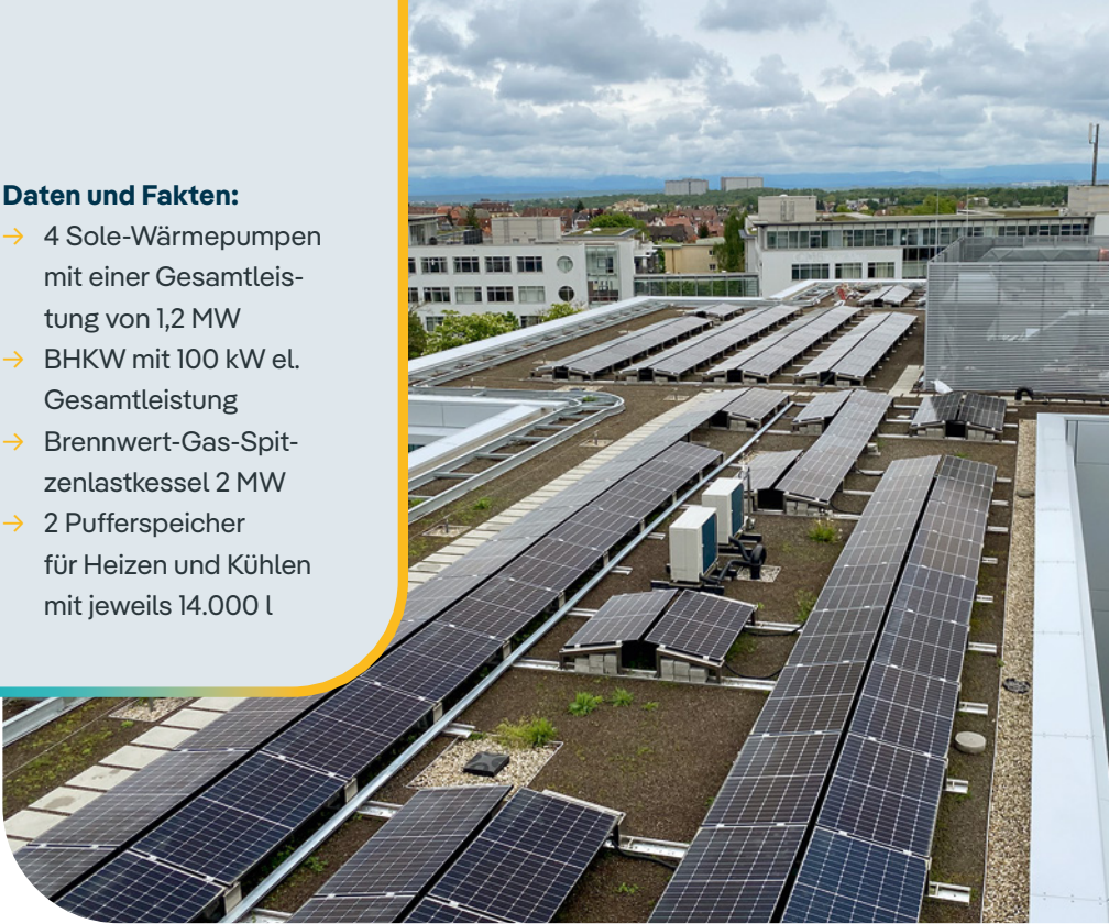
↑ Photovoltaikanlage auf einem Stuttgarter Bürokomplex
